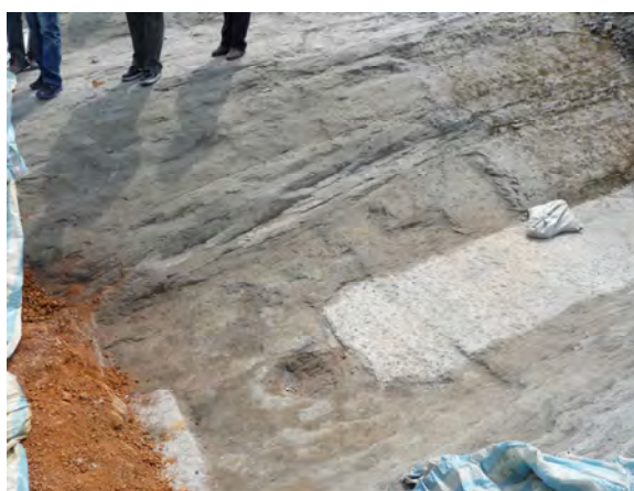
照片八 湖山水庫截水牆缺漏的工程問題現勘
