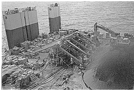
照片十八 高雄興達港卸煤棧橋橋墩海上預疊混凝土 (prepacked concrete) 施工情景 (民國 75 年)
