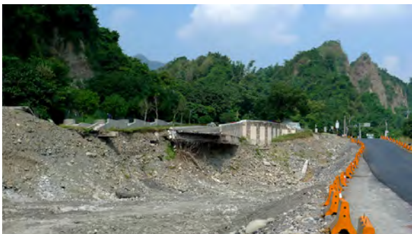
圖二十三 莫拉克颱風豪雨導致許多橋樑受洪水沖走，在河床構築便道(洪如江攝)
