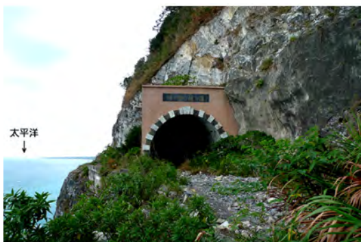
圖九 舊清水隧道東臨3000公尺深的太平洋，西為2000公尺的高山，因位移及破碎而棄用，照片為其北口
