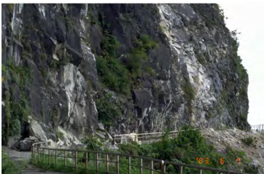
圖八 濱臨太平洋的舊蘇花公路崩塌不斷，早已棄用
