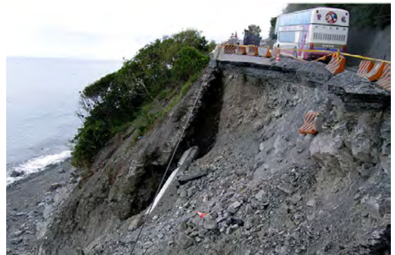
圖十一 台灣東海岸段(台東)公路臨海下邊坡崩塌
