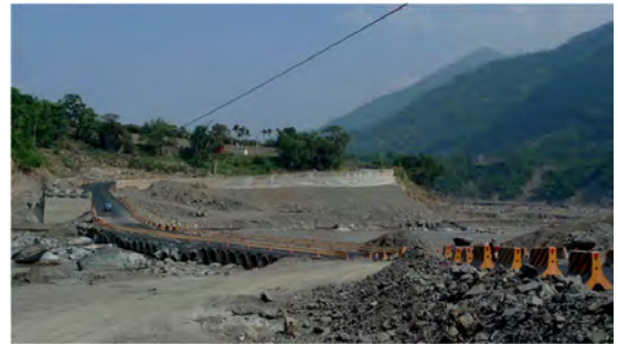
圖二十五 莫拉克颱風豪雨導致許多橋樑受洪水沖走，在河床構築便道(洪如江攝)
