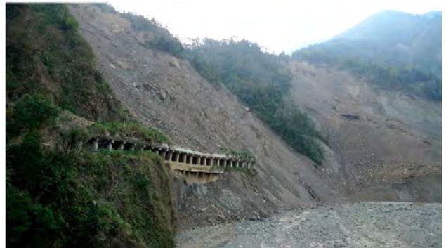
圖三十四 陳有蘭溪上游段的公路全面崩塌，剩下搖搖欲墜的落石棚(洪如江攝)
