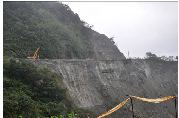
圖三 梅姬颱風引致台 9 線 115k+900 處路基流失
