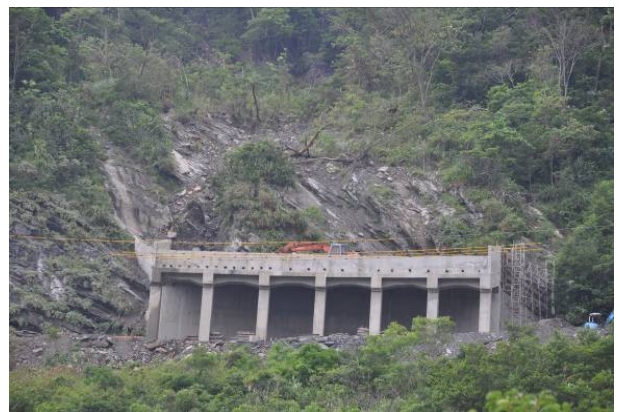
圖十一 谷風地塹上方明隧道之現況
