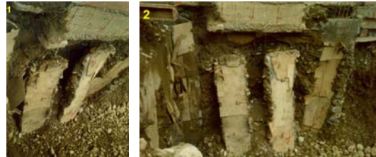
圖十 擋土柱頂部繫樑未閉合發生崩塌破壞
