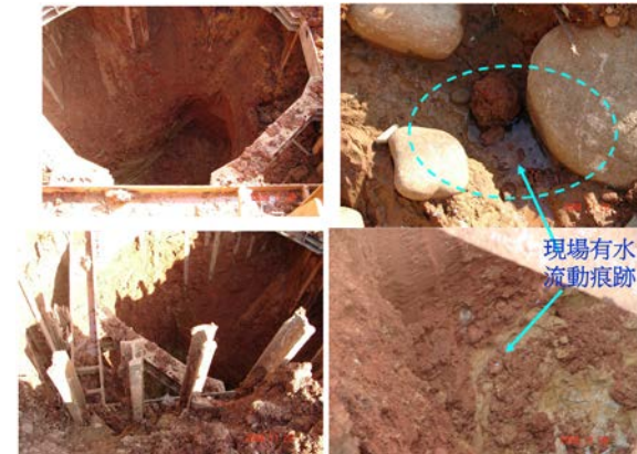
圖九 大肚山麓紅土卵礫石層豎坑開挖崩坍情形
