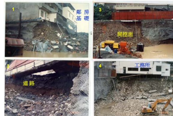
圖八 臺中市某大廈基礎開挖因雨水侵蝕造成地表逕流
