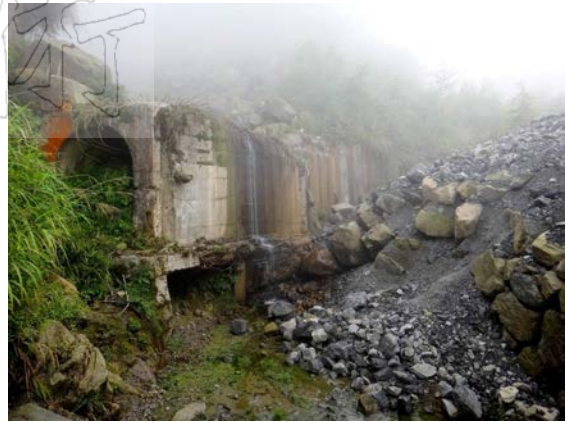
圖六 舊有屏遮那隧道之基底淘刷(高秋振先生提供)
