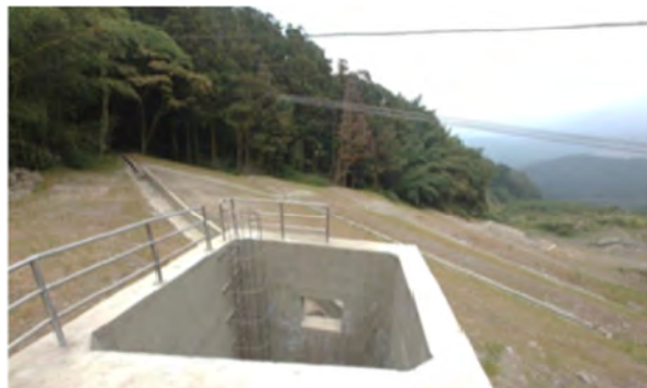
填土區消能井
