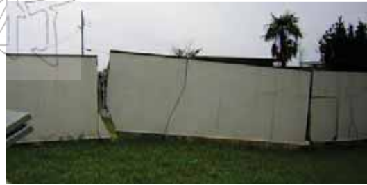
圖 9.22 因地表變位造成之圍牆破壞
